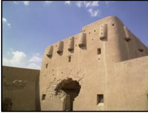
صورة (١٥): تفتت في حائط أحد أبراج قصر خزام في حي التعتل، فبراير ٢٠٢٠م
